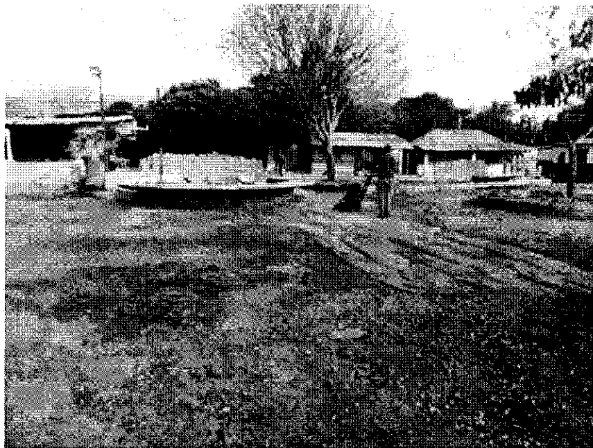
Ilustración 2 Subbase Granular. Incluye Suministro, Extendida, Nivelación, Humedecimiento y Compactación, para Pisos en Losas tipo, cancha de futbol y pista de patinaje. espesor e=20 cm
